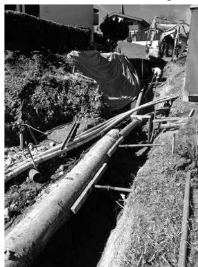
Kabelsalat Bachoffenlegung, Bild: Bruno Egloff
